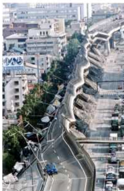
1995年阪神淡路大震災で倒壊した阪神高速道路
